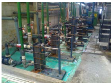
Figura 2. Bombas de 10 HP
