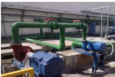
Figura 1. Bomba de 75 y 50 HP
