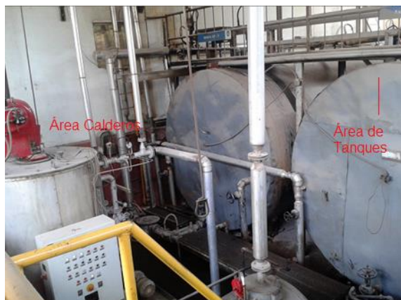
Figura 2.9 Nave de calderos
