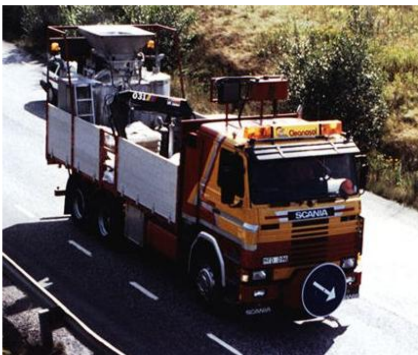
Figura 3.5 Señalización con termo-endurecibles.
