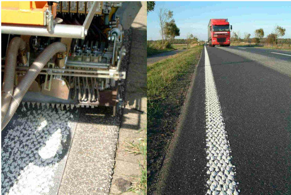
Figura 3.4 Señalización con termoplásticos
