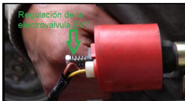
Figura 4.29: Regulación de la válvula solenoide EV1
