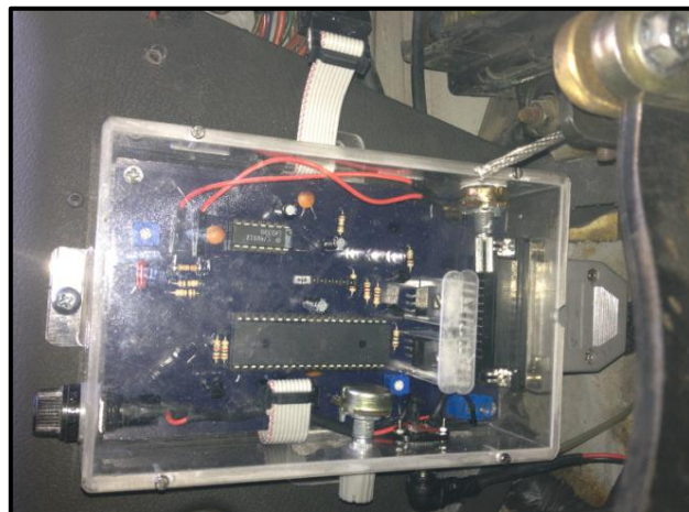
Figura 4.13: Instalación del módulo electrónico
