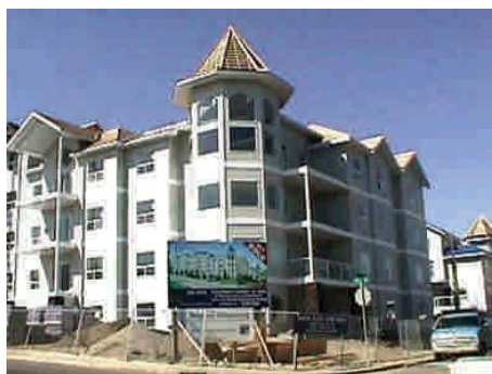
Ilustración 1-3 Edificio de departamentos multifamiliar de cuatro pisos estructurado en madera en 1998, Calgary, Alberta, Canadá
