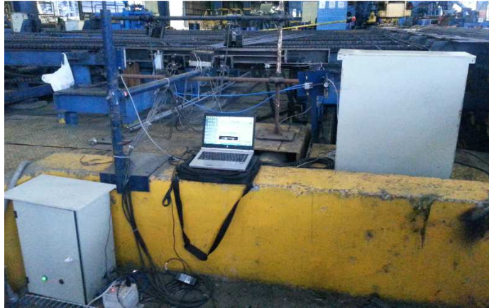
Figura 5.9 Fotografía sistema contador y separador de varillas 202
