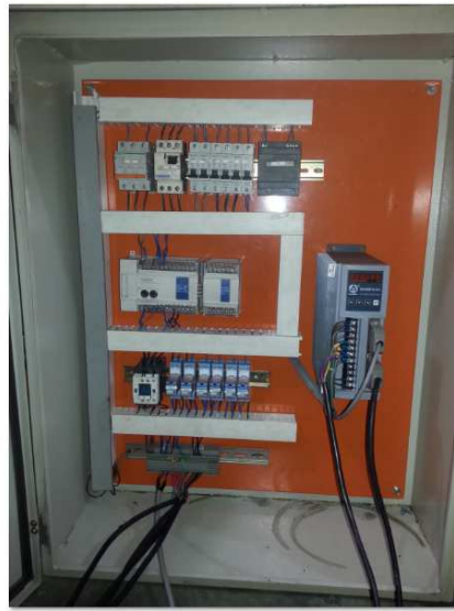
Figura 5.4 Fotografía Armario (AR1) implementado. 195
