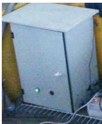
Figura 5.7 Fotografía Armario de alimentación. 199
