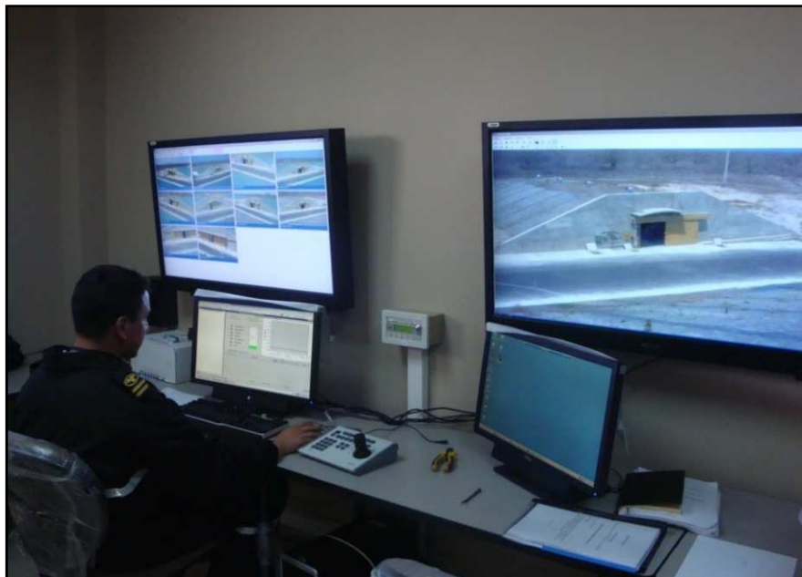
Figura 17. Pantallas de subsistema de video vigilancia en el cuarto de control del Depósito Conjunto de Municiones “Jaramijó”.
