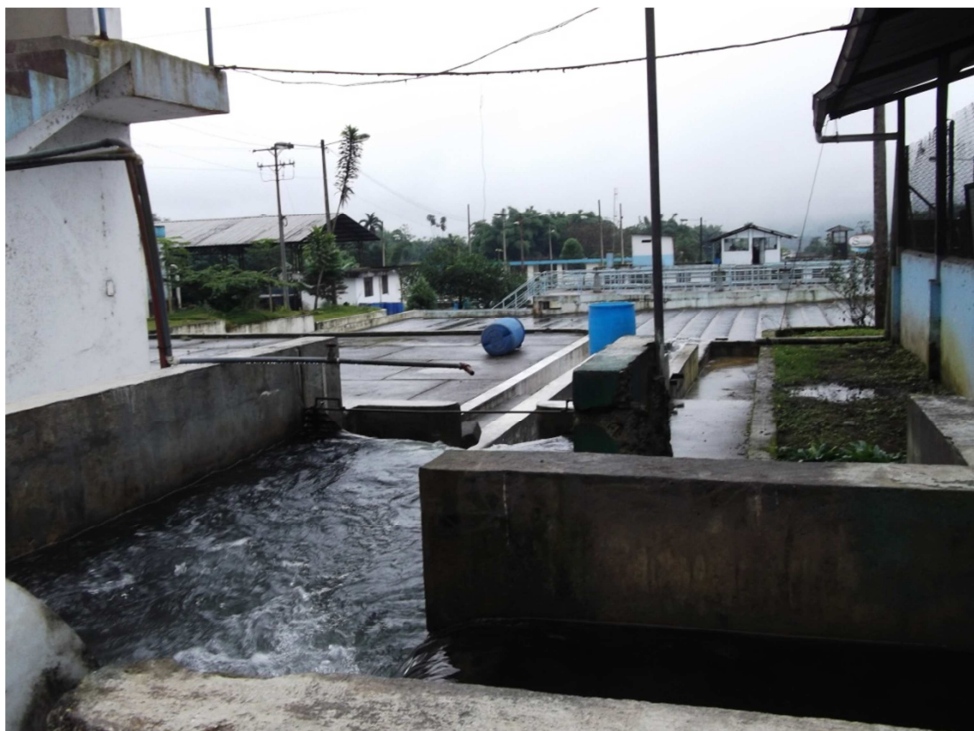
Figura 3.2 Planta de tratamiento, llegada de agua desde captación
