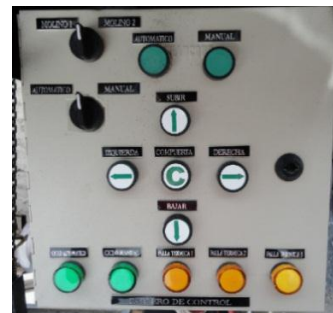
Figura 11: Tablero de mando
