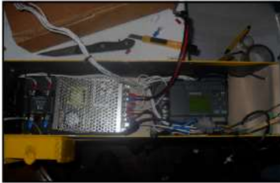
Figura 5. 44. Elementos en la caja protector
