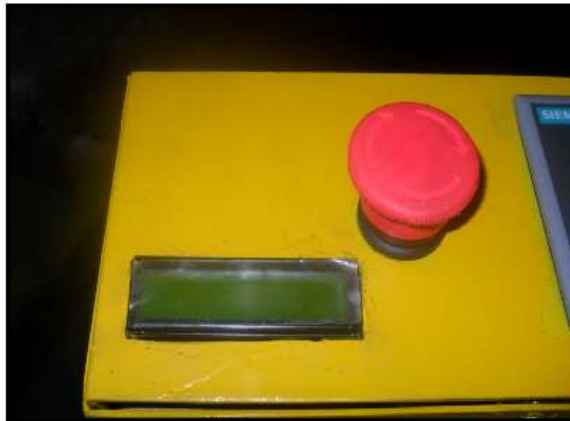
Figura 5.58. Instalación del LCD
