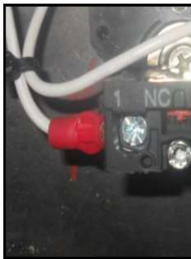
Figura 5.51. Conexión pin 1 botón de emergencia
