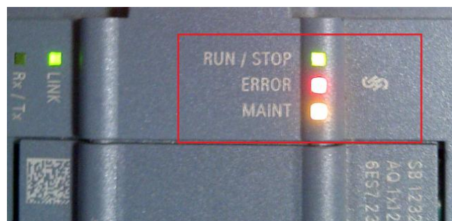
Figura 4.3. Encendido del PLC.
