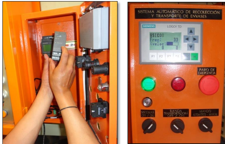
Figura 3.15 Tablero de control. Elaborado por: Roberto Guishcacho y Javier Pilamonta
