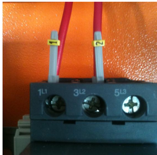
Marquillado de cables
