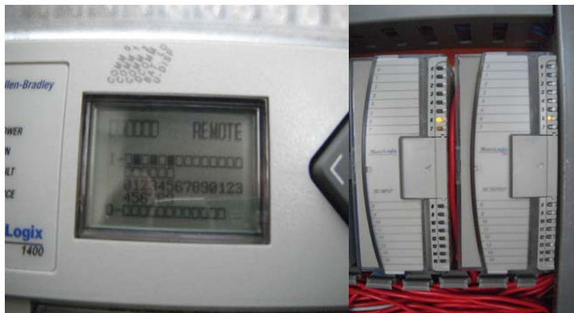
Foto.3.23: PLC y los módulos de expansion Fuente: Empresa AYMESA S.A 2012
