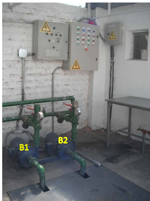
Foto.4.7: Bomba 1, Bomba 2 Fuente: Empresa AYMESA S.A 2012
