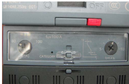
Foto.3.12: Breaker principal Fuente: Empresa AYMESA S.A 2012
