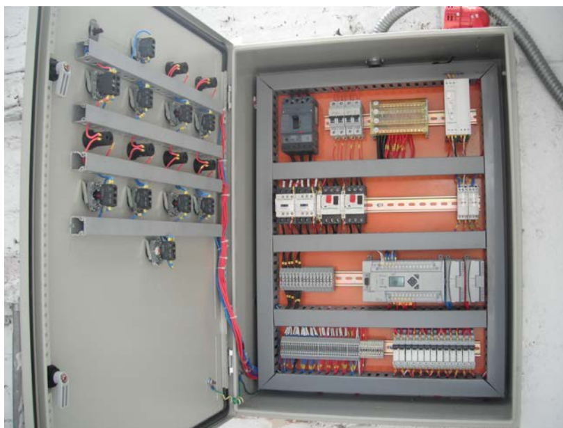
Foto.4.9: Tablero armado Fuente: Empresa AYMESA S.A 2012
