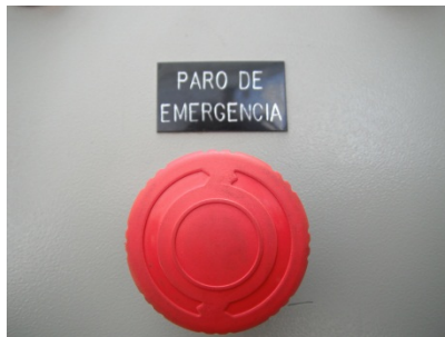
Foto.3.11: Paro de emergencia Fuente: Empresa AYMESA S.A 2012
