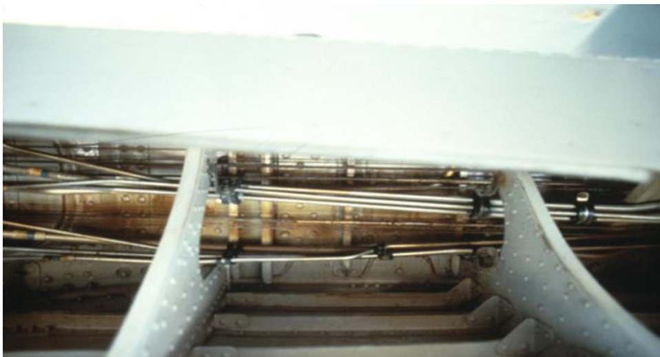
Figura 2.4: Corrosión uniforme de la superficie
