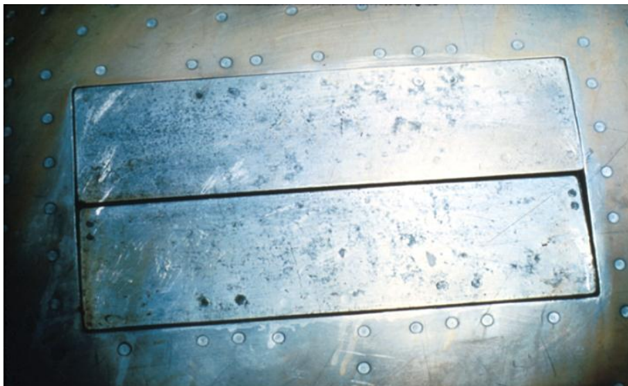
Figura 2.5: Corrosión por Picadura
