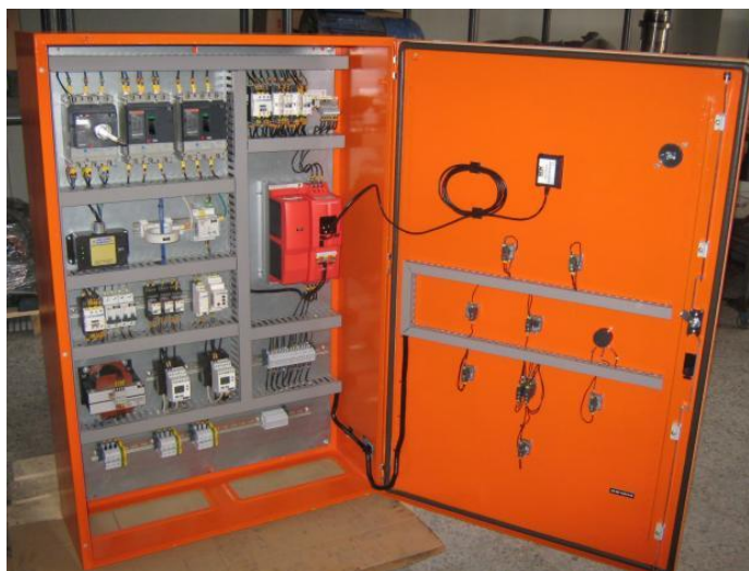
Figura 126 Tablero de control eléctrico.
