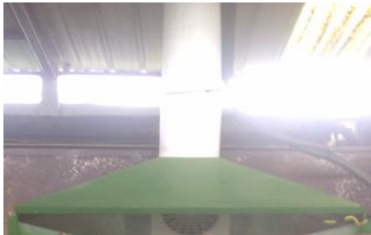
Figura 0.27: Ensamble de los Ductos de Recirculación.
