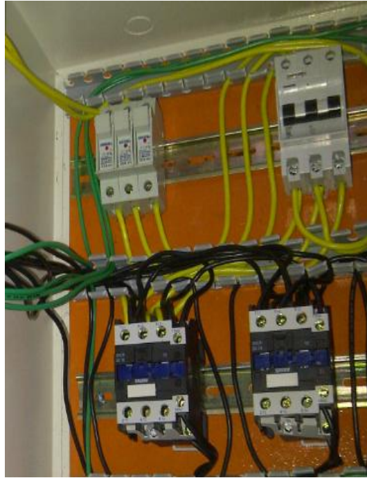
Figura 0.41: Cableado del Sistema de Fuerza.
