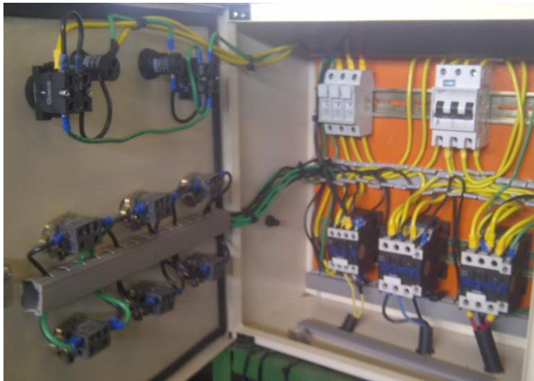
Figura 0.39: Montaje del Tablero de Control.
