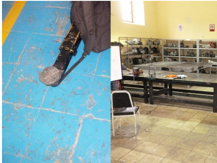
Figura 3. 4 Piso en mal estado
