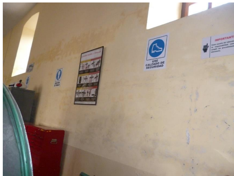
Figura 3. 5 Paredes en mal estado
