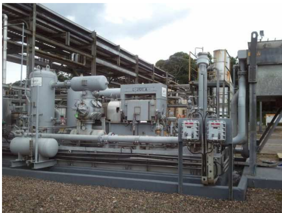
Fig. 3: Compresor de Gas C-3121A
