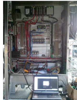
Fig. 10: Conexión realizada entre el PLC y la PC
