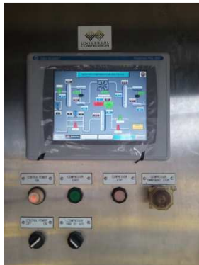
Fig. 11: Panel Local con el Compresor en funcionamiento
