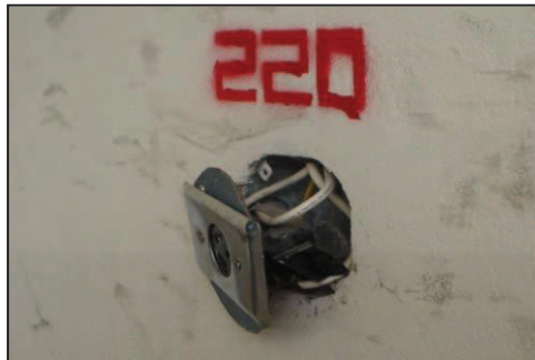
Foto 6.2: Material en mal estado
