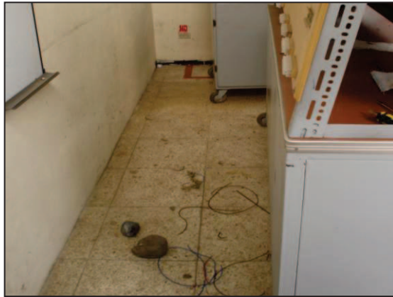
Foto 6.9: Falta de mantenimiento Fuente: Antiguo laboratorio de Control Industrial Elaborado por: Cbos. Guanín Roberto
