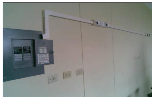
Foto 6.40: acometida trifásica instalada Fuente: Laboratorio de Control Industrial Elaborado por: Cbos. Guanín Roberto
