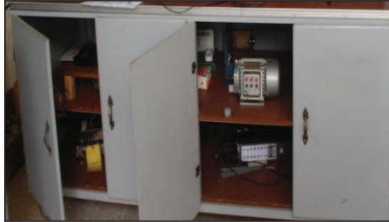
Foto 6.5: Equipos sin seguridades adecuadas
