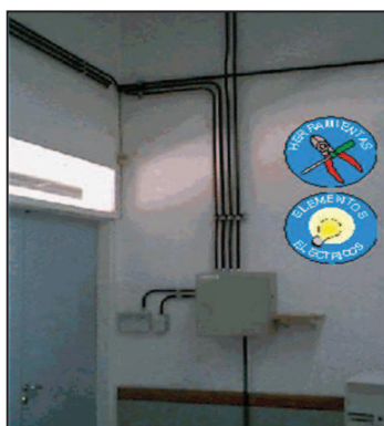
fig. 3.5: Instalación eléctrica tipo exterior
