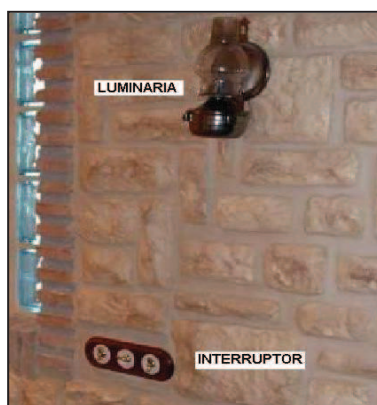
fig. 3.4: Instalación eléctrica tipo embutida
