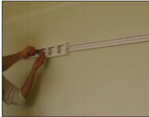
Foto 6.38: Instalación de la acometida trifásica
