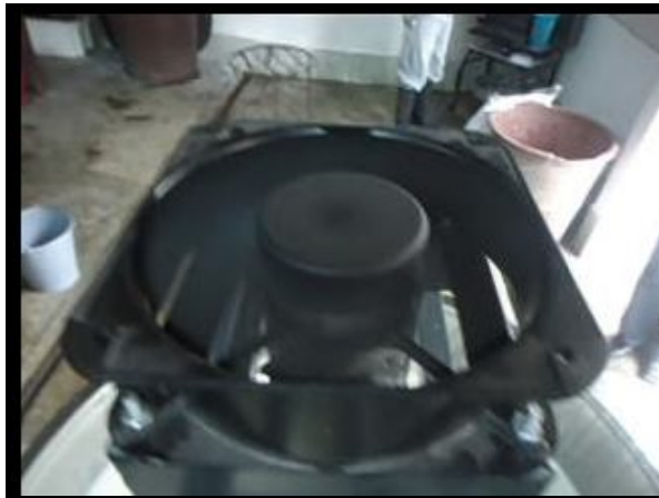
Foto 18. Ventilador instalado para enfriar el motor Elaborado por: Santiago Villavicencio
