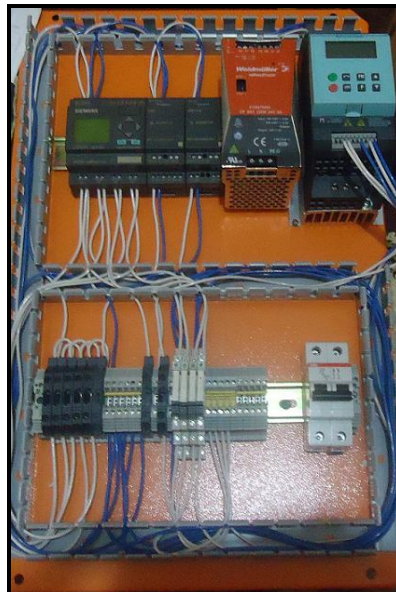
Foto 6. Conductores en el Tablero de Control Elaborado por: Santiago Villavicencio
