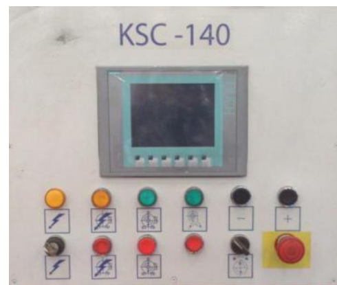
Figura 12. Nuevo diseño de tablero de control implementado
