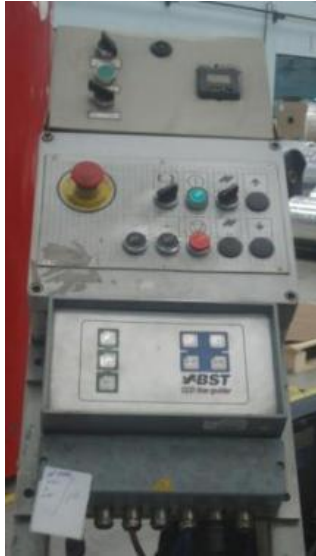
Figura 13. Controlador BST obsoleto
