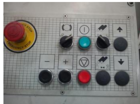
Figura 15. Tablero de control posterior
