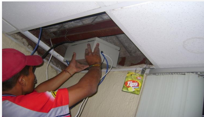
Figura 4.36: Instalación del Equipo Mikrotik en el Edificio.
