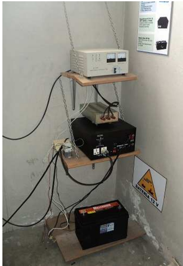
Foto 3.1 Estado inicial de los equipos del aerogenerador.
