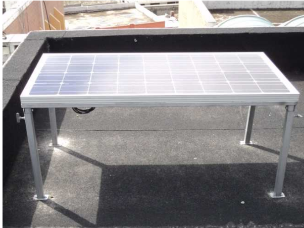
Foto 3.12 Panel solar sobre el soporte.
