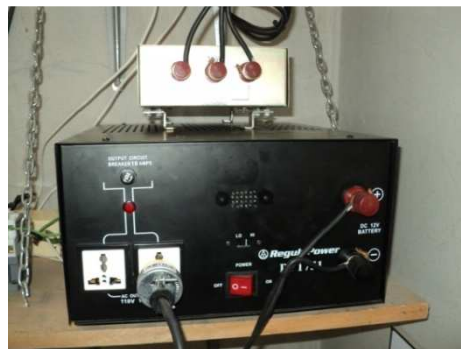
Foto 2.3 Inversor y sus conexiones.
