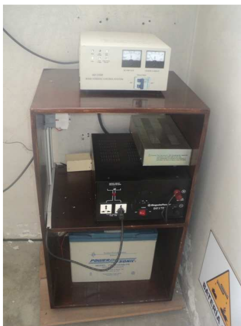
Foto 3.17 Tablero de equipos instalados
