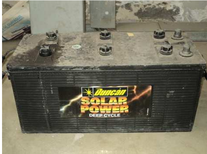
Foto 3.2 Batería de ciclo profundo SP160.
