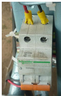
Figura 4.20 Elemento de protección Breaker
