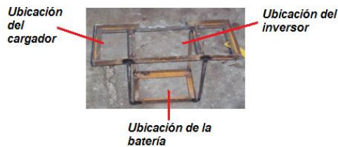
Bases para elementos eléctricos.
