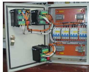
Figura 4: Panel de Analizadores de Red
