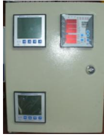
Figura 5: Panel de Analizadores de Red - Vista Frontal
