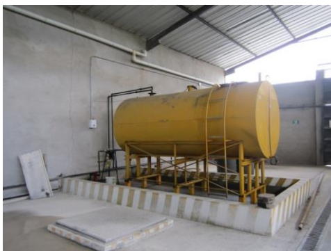
Figura 3. 9. Tanque de Diésel.
