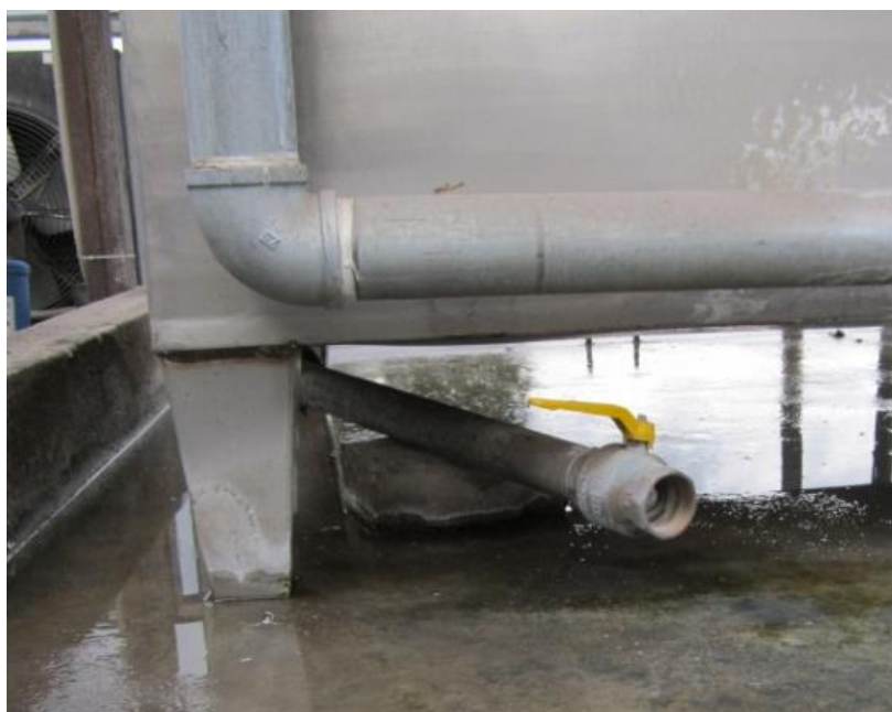
Figura 3. 15. Válvula para la purga de la torre de enfriamiento
