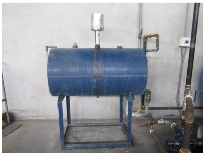
Figura 3. 8. Tanque de condensado.
