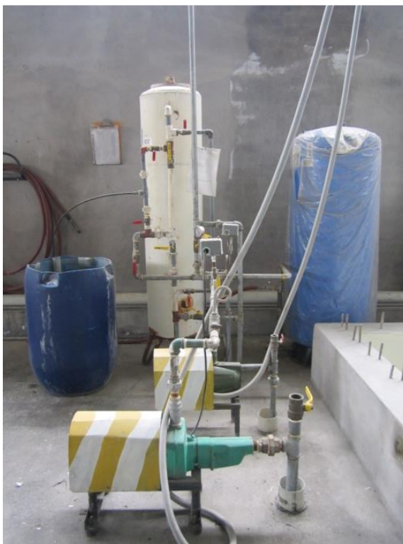
Figura 3. 7. Sistema de ablandamiento de agua.
