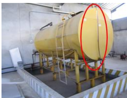
Figura 3. 12. Tanque de diésel, e indicador de nivel
