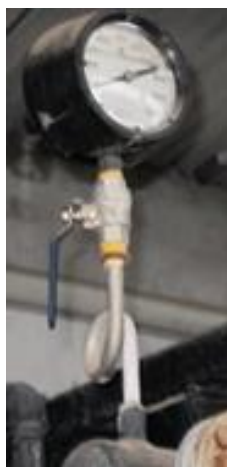
Figura 3. 13. Estado actual de los medidores de presión.
