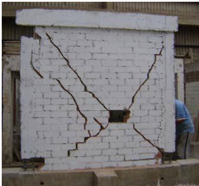
Figura 3.4 Muro antes de la reparación. (Cortesía Ángel San Bartolomé)
