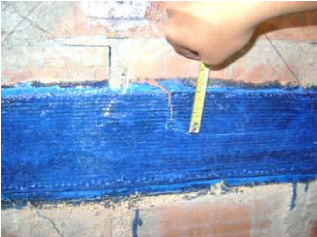
Figura 3.10 Fisura fuera de la zona reparada (Cortesía de Ángel San Bartolomé)
