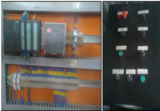
Figura N° 9: Cabina de control (PLC y botoneras).
