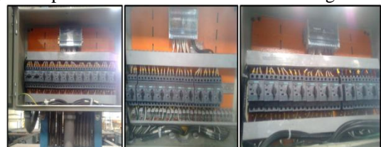
Figura N° 7: Cajas de distribución eléctricas.
