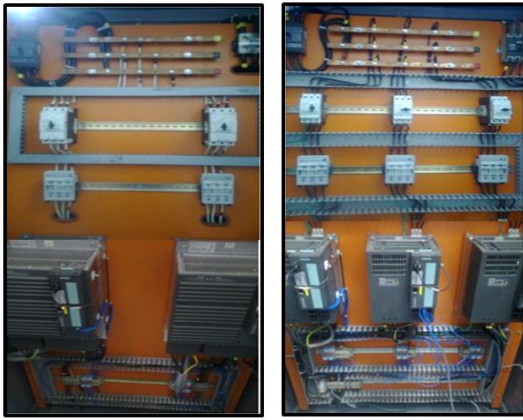
Figura N° 8: Tableros eléctricos de mando y protección.
