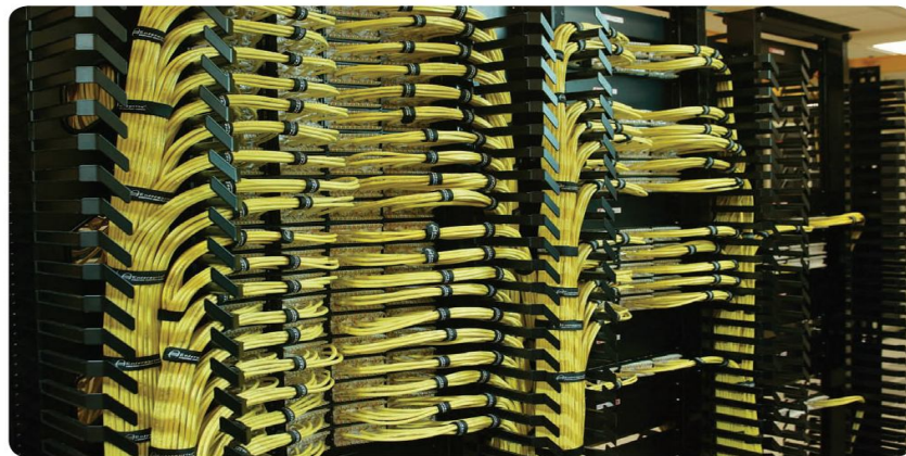
Imagen No. 3. 6 Cableado de Centro de Datos (ADC, 2012)
