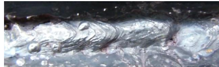
Sur GMAW Viga principal (socavado, chisporoteo excesivo y falta de penetración)
