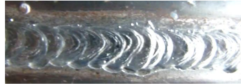
Sur SMAW Viga secundaria (socavado)
