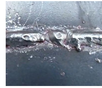
Norte GMAW Viga secundaria (falta de homogeneidad, perfiles de soldadura)
