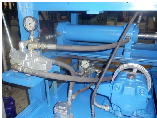
Figura 5.5 Vista de los manómetros y válvulas
