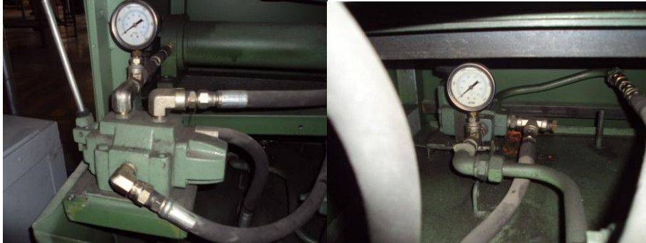
Figura 3.27 Los manómetros no marcan presión
