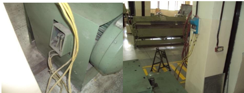
Figura 3.34 Conexiones eléctricas inadecuadas
