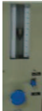
Figura 12 Rotámetro línea de alimentación de agua
