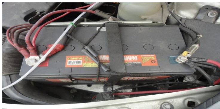
Figura No. 5.16: Conexiones a la batería principal
