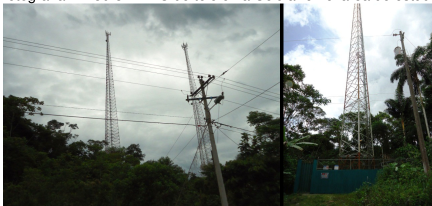
Fotografía N° 30-31: EBC de telefonía Celular en el área de estudio
