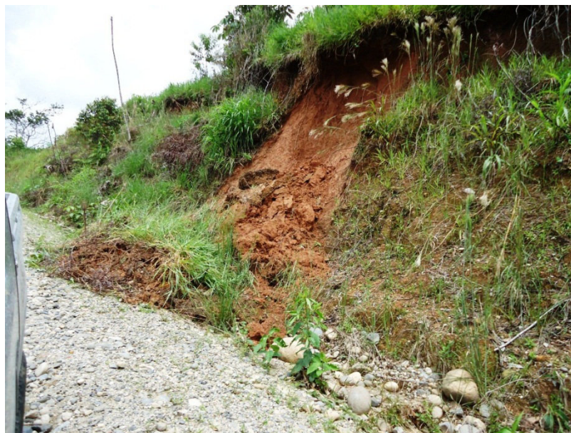
Fotografía N° 22: Deslizamientos, parte semi-alta Colonia Gavilán.
