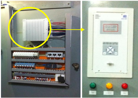
Figura 7. Regulador de Voltaje, DECS200.
