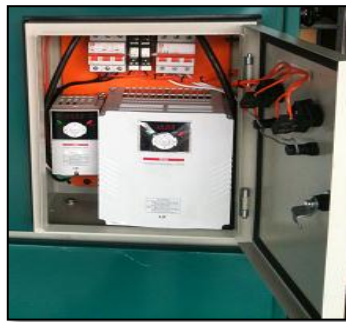
Figura 3. 66: Tablero de fuerza y control montados. Fuente: Grupo de investigación.
