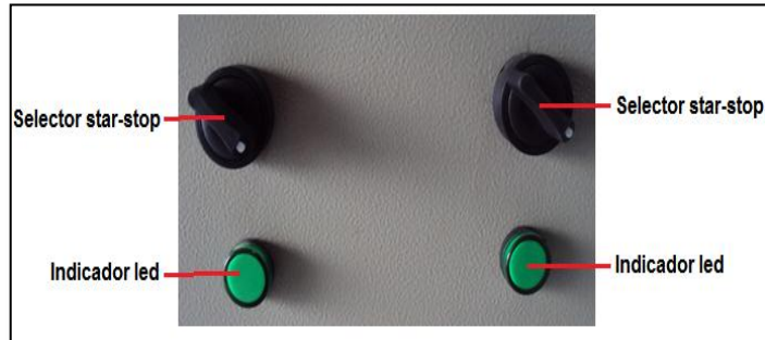
Figura 3. 65: Circuito de control dos montado. Fuente: Grupo de investigación.
