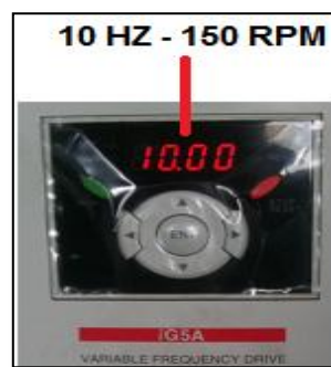
Figura 4. 84: Regulamos 150 PRM, en el variador de 10 HP. Fuente: Grupo de investigación.
