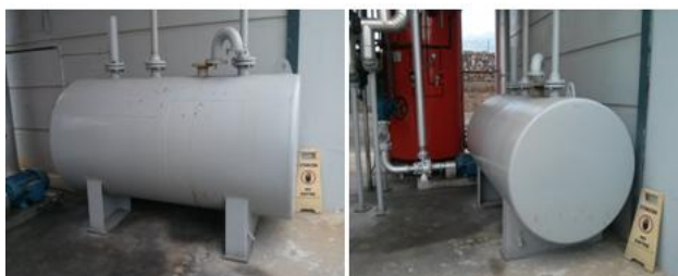
Figura 16 Tanque de almacenamiento de aceite térmico
