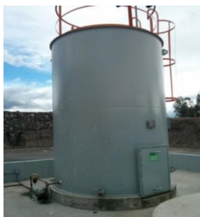
Figura 12 Tanque de almacenamiento de diésel
