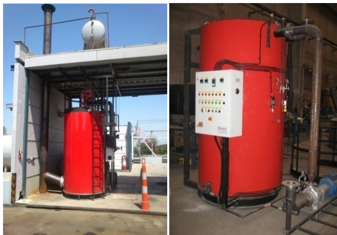
Figura 14 Caldero de fluido térmico
