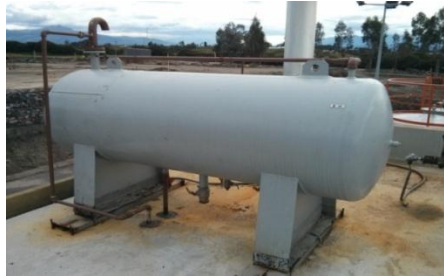
Figura 13 Tanque de alimentación de diésel
