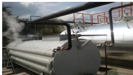
Figura 11 Tanque de reproceso
