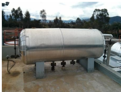
Figura 17 Tanque de expansión de aceite térmico
