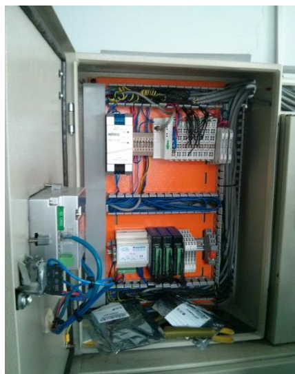
Figura 110 Tablero de equipos para la automatización
