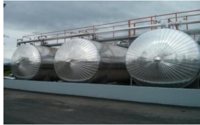
Figura 10 Tanques de Almacenamiento de Asfalto
