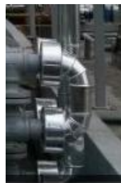
Figura 5 Codo aislado con cañuela de fibra de vidrio
