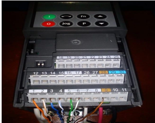
Foto 7. Terminal puesta en servicio con el panel SDP Elaborado por: Wilson Zumba
