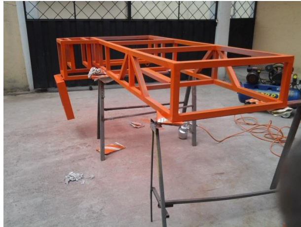
Fuente: Grupo de Investigación Figura 4.22: Primera capa de pintura en la estructura
