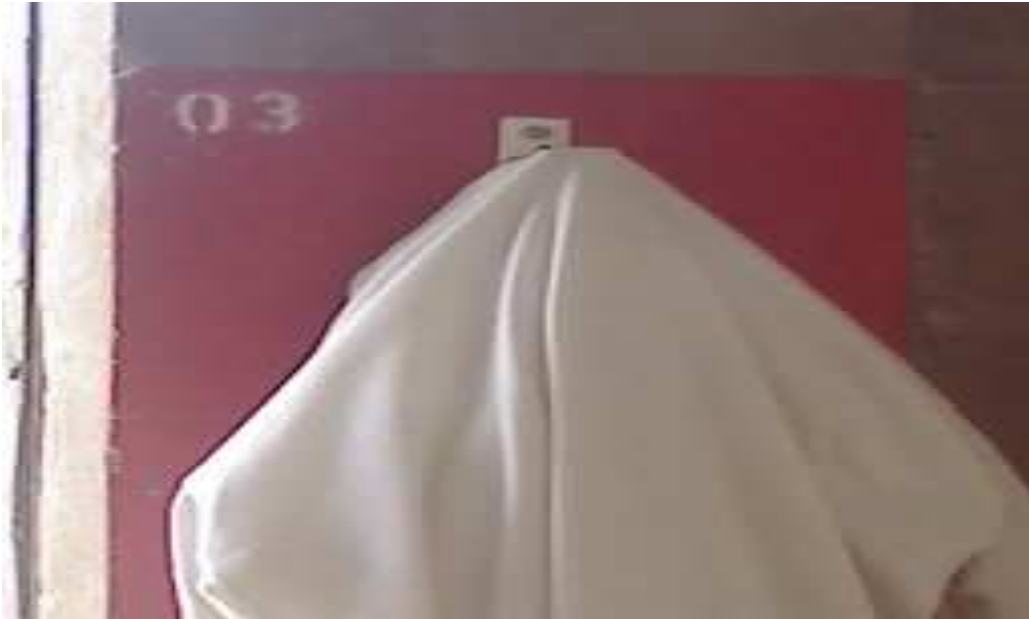
Figura D.5 Uso inadecuado del lugar donde se ubica el extintor
