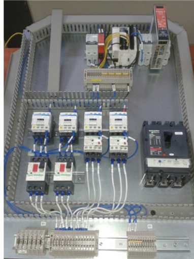
Figura 4.19 Cableado de Contactores y salidas del PLC Fuente: (Autor, 2014)
