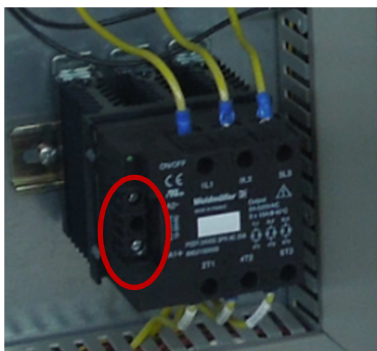
Figura 5.10 Relé de estado sólido para la activación del calentador # 3 Fuente: (Autor, 2014)
