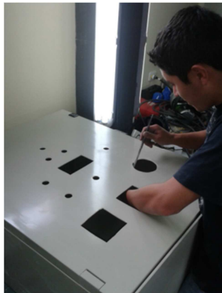
Figura 4.20 Prensado para hacer orificios en la puerta del tablero de control Fuente: (Autor, 2014)
