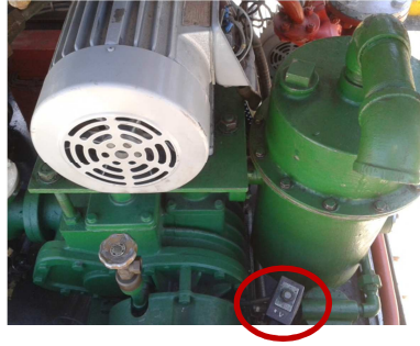
Figura 5.7 Electroválvula SV1 lubricación bomba de vacío
