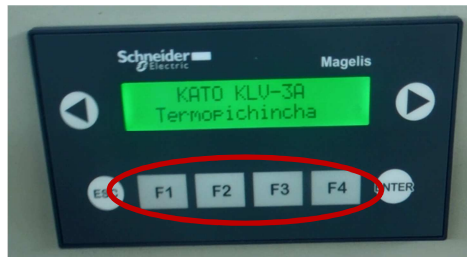
Figura 6.31 Teclas para encendido de cargas Fuente: (Autor, 2014)
