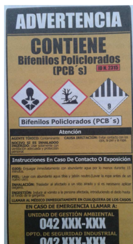
Figura 8.3 Etiqueta de un transformador con aceite contaminado de PCB's Fuente: (Moreno & Pilco, 2012, pág. 115)
