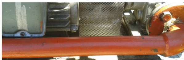
Figura 2.8 Sección de tubería posterior a bomba de engranajes Fuente: (Autor, 2014)
