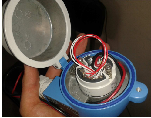
Figura 4.17 Cableado del transmisor de temperatura Fuente: (Autor, 2014)
