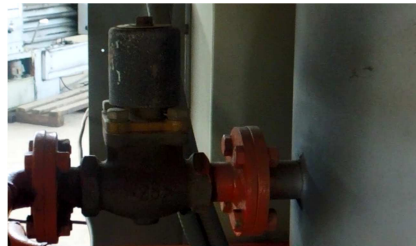
Figura 5.8 Electroválvula SV2 entrada aceite a tanque principal
