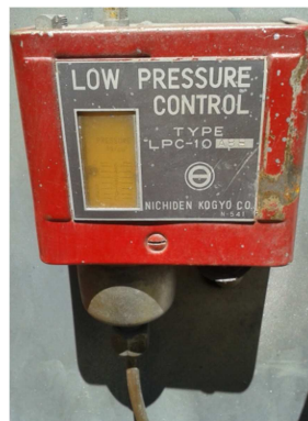
Figura 2.6 Control presión antiguo Fuente: (Autor, 2014)
