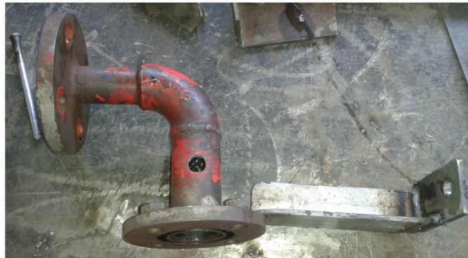
Figura 4.10 Agujero en la tubería de salida Fuente: (Autor, 2014)
