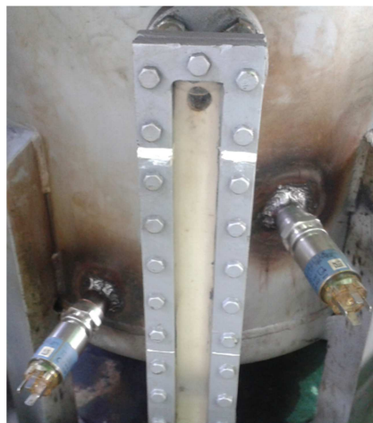
Figura 6.7 Detectores de nivel montados en el tanque principal
