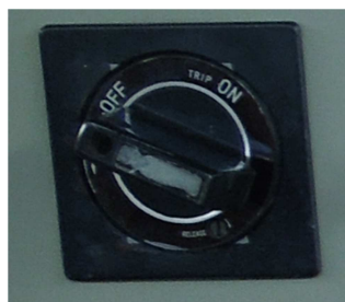
Figura 6.10 Interruptor principal grande Fuente: (Autor, 2014)
