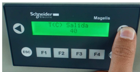
Figura 6.23 Panel de temperatura de salida Fuente: (Autor, 2014)
