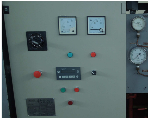
Figura 6.9 Tablero de control Fuente: (Autor, 2014)
