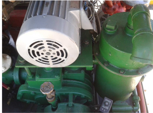
Figura 2.19 Bomba de vacío y tanque de aceite Fuente: (Autor, 2014)
