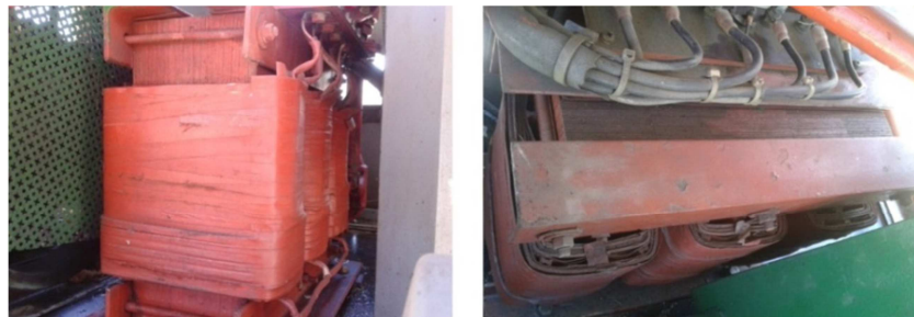
Figura 2.23 Transformador Fuente: (Autor, 2014)
