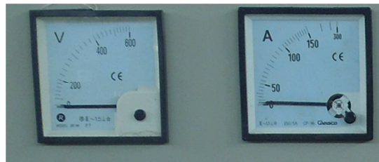
Figura 6.11 Voltímetro y amperímetro Fuente: (Autor, 2014)
