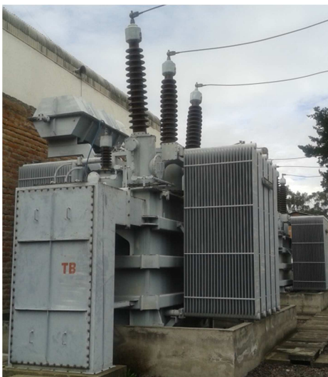
Figura 1.1 Transformador de 20 MVA Termopichincha Fuente: (Autor, 2014)
