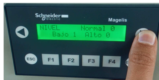
Figura 6.25 Panel de nivel de aceite Fuente: (Autor, 2014)
