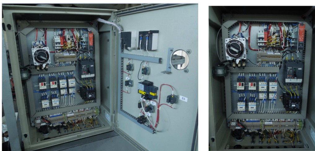
Figura 4.23 Montaje completo del tablero de control
