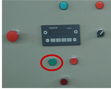
Figura 6.32 Frente del panel de control Fuente: (Autor, 2014)
