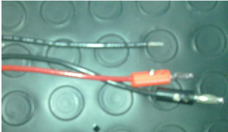
Figura 4. Cables y terminales eléctricos
