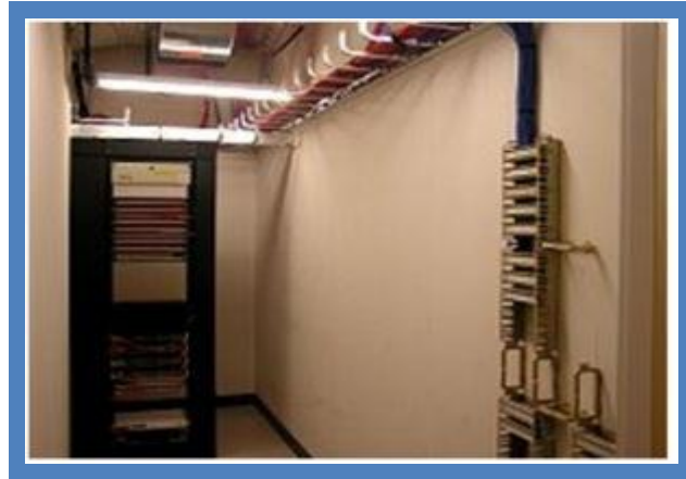
Figura 2. 40 Closet de Comunicaciones
