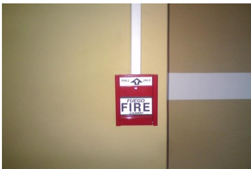
Figura 13. Periférico "Estación Manual".
