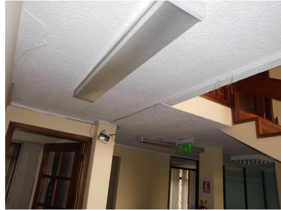
Figura 11. Canaleta instalada en el tumbado en la planta alta 1.
