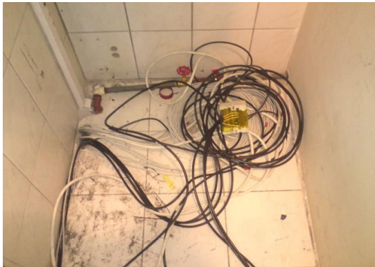
Figura 10. Estado inicial del cableado en cuarto de control.
