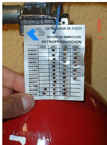
Foto No. 52. Placa de inspección de extintores
