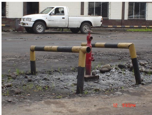
Foto No. 46. Hidrante
