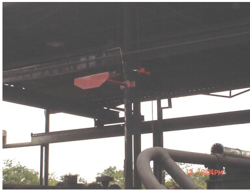
Foto No. 44. Detectores de Incendios
