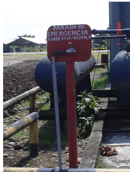
Foto No. 49. Paradas de Emergencia
