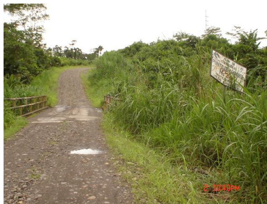
Foto No. 33. Señalización de Punto de Control en mal estado
