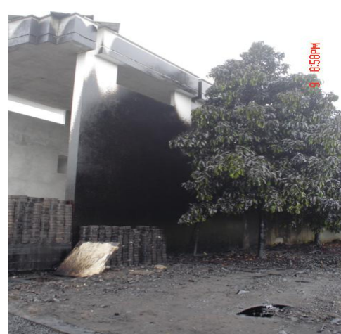
Foto No.2. Riesgo debido a actividad humana
