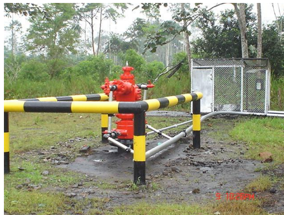
Foto No.4. Plataforma de Pozo Power Oil
