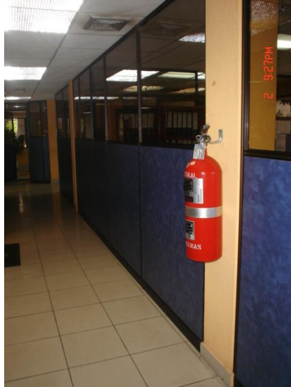
Foto No. 16. Extintor de CO2 ubicado en las oficinas de la Estación Sacha Central
