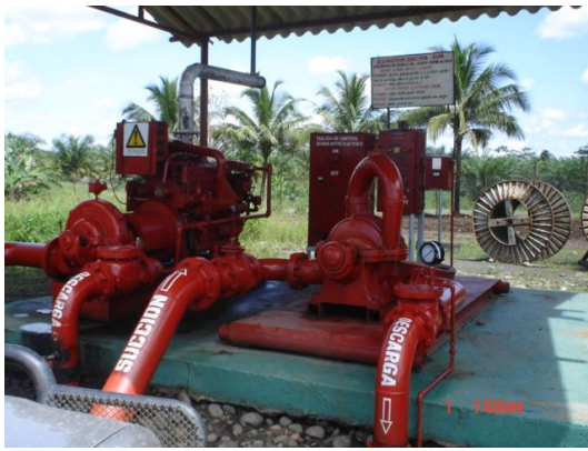
Foto No. 36. Der: Bomba principal eléctrica Izq: Bomba auxiliar a diesel
