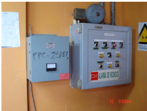
Foto No. 48. Alarma de Incendios
