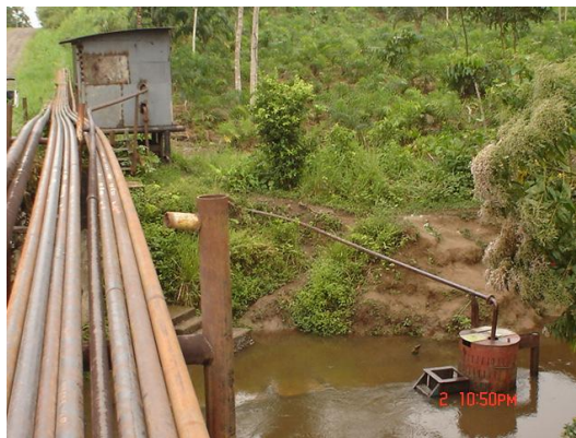
Foto No.12. Bomba de Captación (Río Parker)
