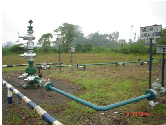
Foto No.13. Pozo Inyector
