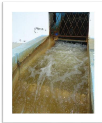
Figura N° 1.6: Canal de Parshall
