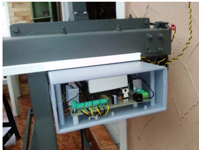
Figura 5.19 Caja de control instalada. (Fuente: Propia).
