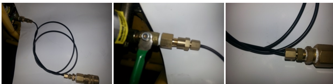
Figura 4. 2 Manguera y conjunto de acoples implementados en la etapa de generación
